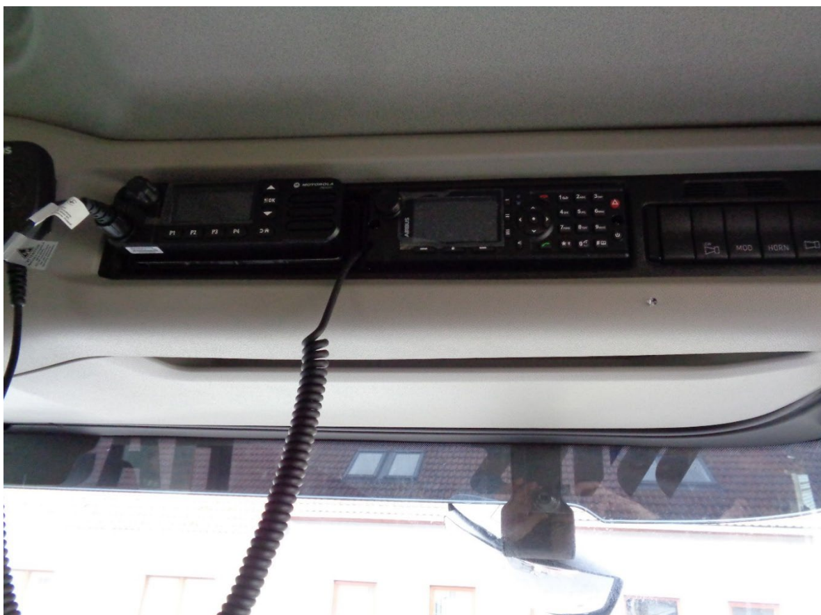
Příklad umístění radiostanic v kabině vozidla.
